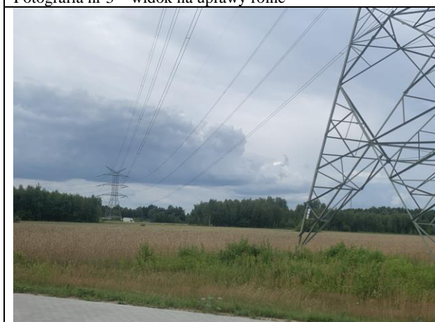
Fotografia nr 5 – widok na przebieg linii elektroenergetycznej WN
