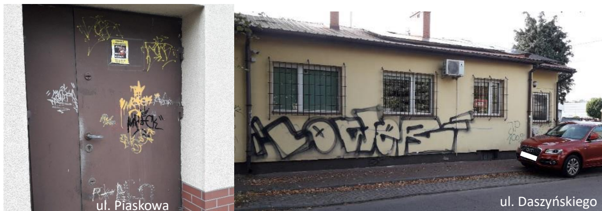
Fot. 1. Przykłady wandalizmu na obszarze rewitalizacji
