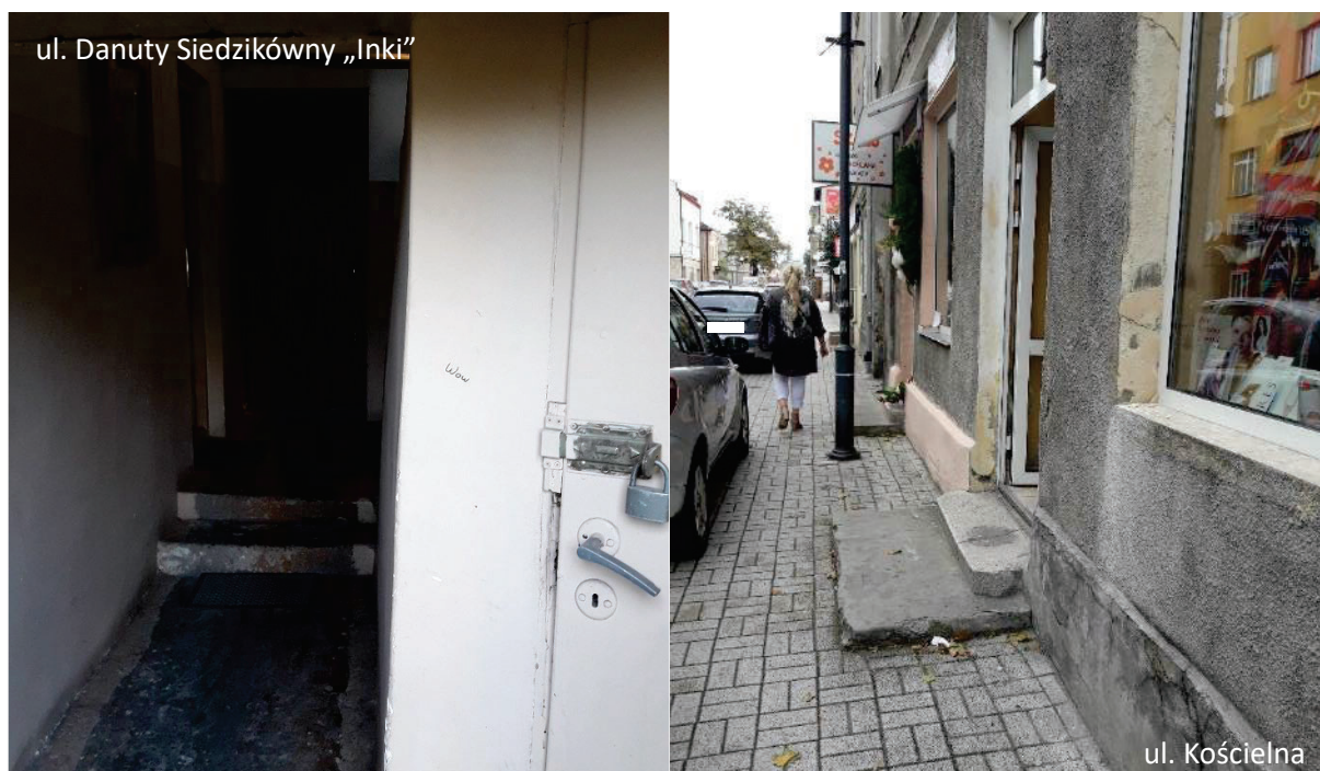
Fot. 12. Przykłady barier architektonicznych w budynkach na obszarze rewitalizacji
