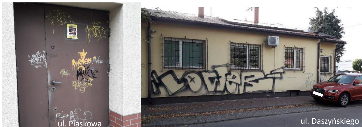
Fot. 1. Przykłady wandalizmu na obszarze rewitalizacji
