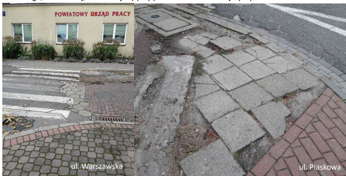
Fot. 6. Przykłady zniszczonej nawierzchni ciągów pieszych na obszarze rewitalizacji
