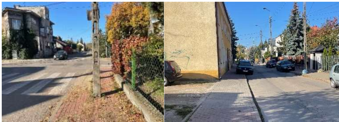
Ulica Sienkiewicza – parkowanie z wykorzystaniem chodnika, miejscami znacznie ograniczające szerokość chodnika, słupy w pasie ruchu pieszego, zła jakość nawierzchni.
